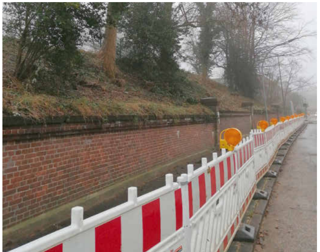
Sanierungsbedürftig: Um die Mauer am Fußweg in der Fehrsstraße instand setzen und die Verkehrssicherheit wieder herstellen zu können, müssen die Bäume auf der Böschung weichen.
