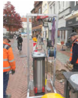
Am Haken: Ende Oktober wurden in der Breiten Straße zwei Poller verkabelt und in die Fundamentkästen eingebaut.
