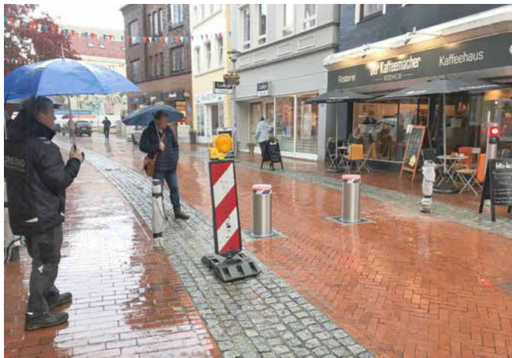
Funktioniert auch bei Regen: Björn Faust (r.) von der Tiefbauabteilung lässt sich die installierten Poller im Testlauf von Predio-Mitarbeiter Wolfgang Hoffmann vorführen.
