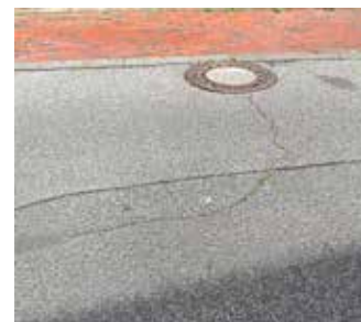
Schadhafter Asphalt: Die Tiefbauabteilung repariert die großen Risse, kleinere Ausbesserungen erledigt der Bauhof.
