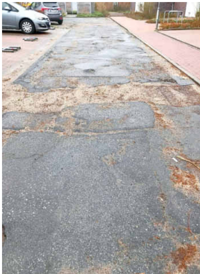
Schäden: Hier soll DSK schnelle Abhilfe schaffen.
